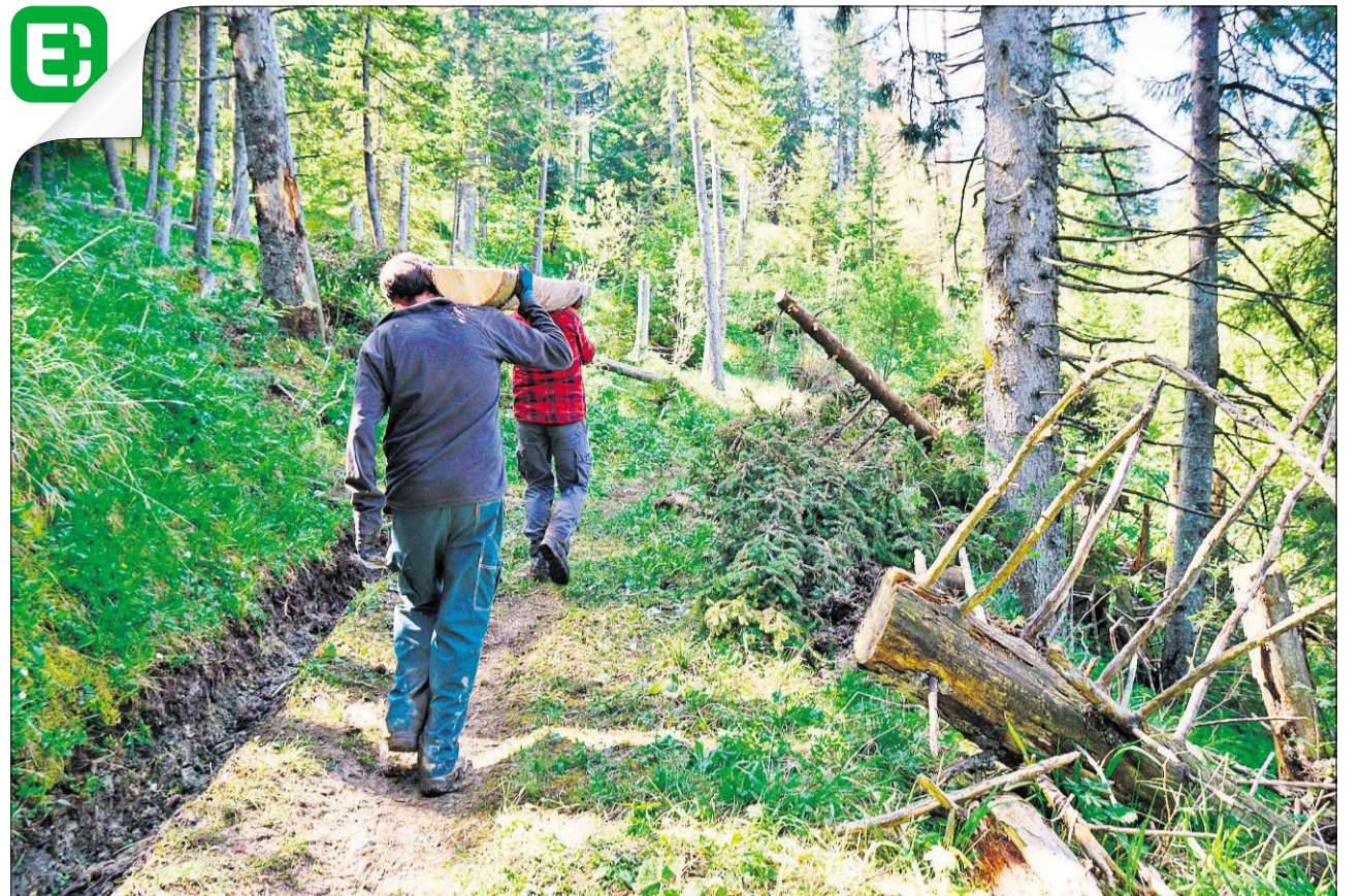
Holz für die Brücke wird herbeigetragen. [Hinter diesem Bild verbirgt sich eine Bildergalerie, die mit der Extra-App aktiviert werden kann.]
